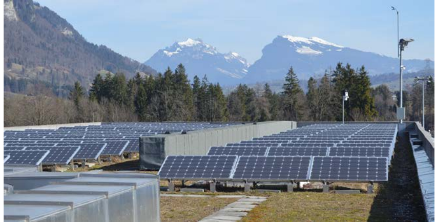
Photovoltaikanlage auf dem Hauptgebäude des Tropenhaus Frutigen.
