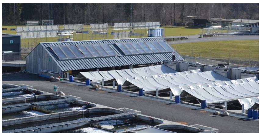
Sonnenkollektoren auf der Reinigungsanlage.
